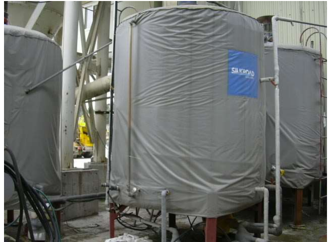
사진-5 혼화제 저장고의 보온덮개
